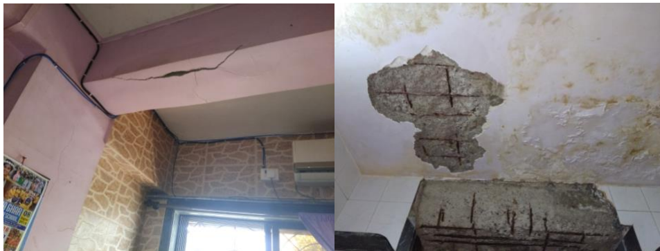
Schade aan constructie en pleisterwerk
