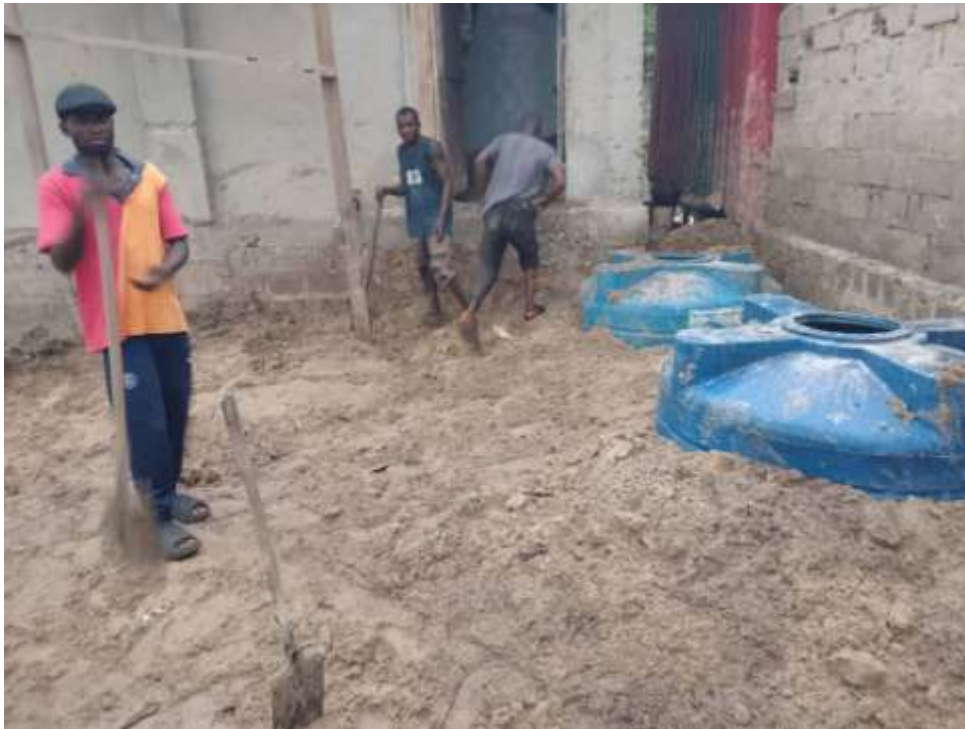
De septic tanks voor het toiletgebouw.
